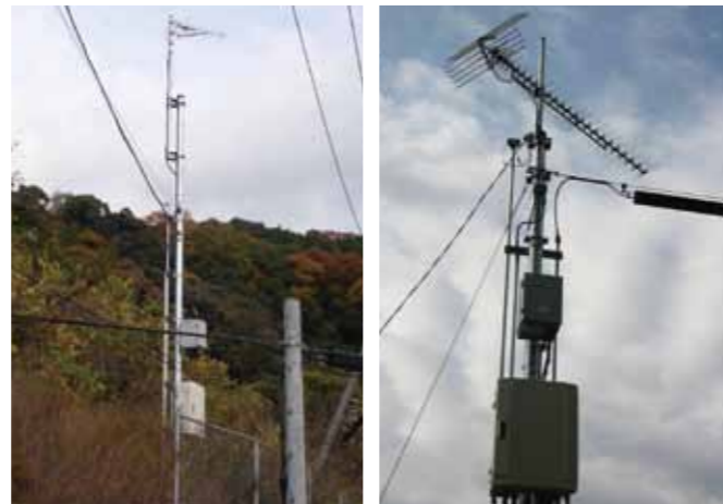
地上デジタル放送難視聴対策 (ギャップフィラー) 町内60箇所に中継局を設置し、各家庭にテレビの電波を送信しています。
