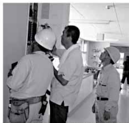
配電盤の点検を行う組合員の皆さん(野上第一保育所で)
